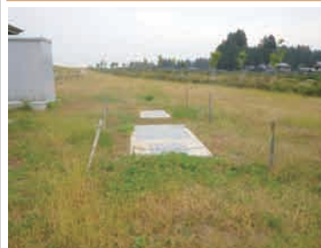
一次処理槽と消毒・貯留槽、土壌浸潤槽
