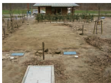
分水マス（手前）と土壌浸潤槽
